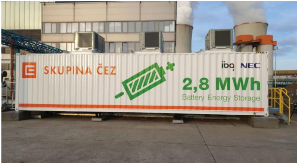
Obr. 24 Bateriové úložiště v Tušimicích společnosti ČEZ 140
