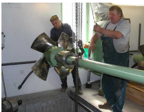
Obr. 19 Kaplanova turbína v Třeboradicích 120
